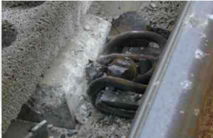
Zerstörungsbild der Festen Fahrbahn auf der Umfahrung Melk im Jänner 2001
